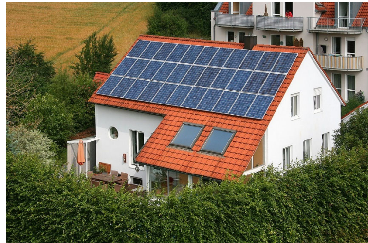
Photovoltaik Anlage auf Einfamilienhaus
